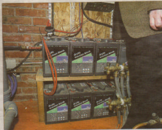
I husets teknikrum finns ett elsystem med batterier, där man kan spara el för kommande behov. Bra om det blir strömavbrott.
